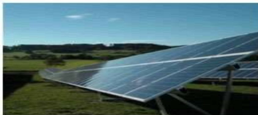
Fig. 24 - Module fotovoltaice montate pe structuri fixe pe sol
