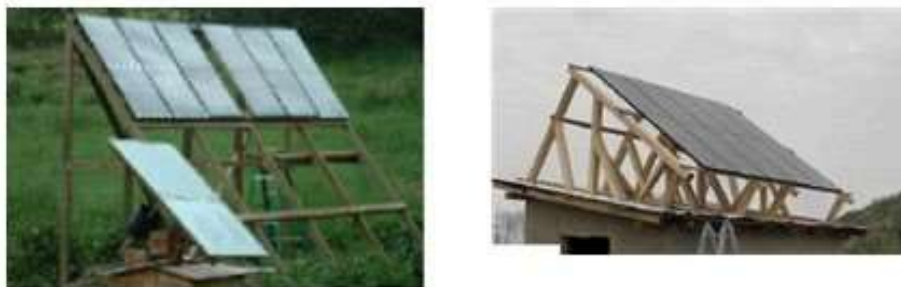
Fig. 23. Structuri de lemn pentru montarea panourilor fotovoltaice la o locuință
