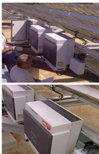
Fig. 19. Exemplu de montare în exterior a invertoarelor
