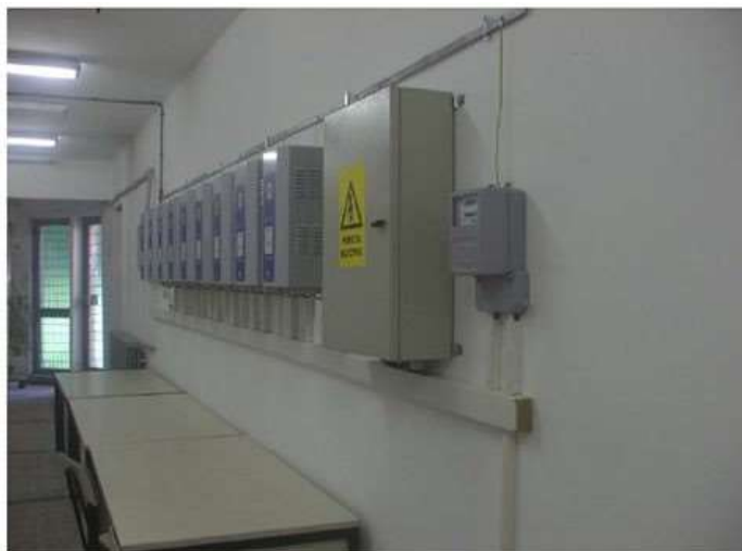
Fig. 20. Exemplu de montare în interior a invertoarelor
