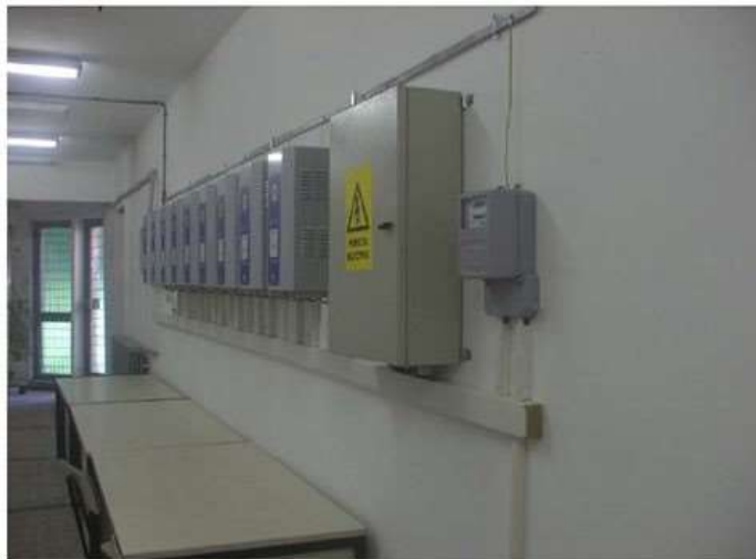
Fig. 20. Exemplu de montare în interior a invertoarelor
