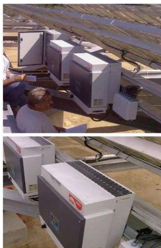
Fig. 19. Exemplu de montare în exterior a invertoarelor
